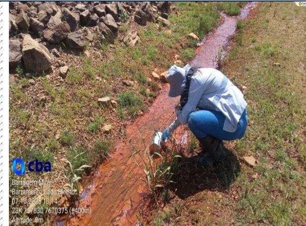
Figura 11: Registro fotográfico do ponto dreno de pé direito, no mês de outubro/2025.
