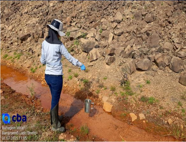
Figura 8: Registro fotográfico do ponto dreno de pé direito, no mês de julho/2025.
